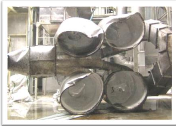
แสดงชุดไซโคลนเย็นทั้ง 4 ลูกขาดกลาง แยกเป็นส่วนบนกับส่วนล่าง
